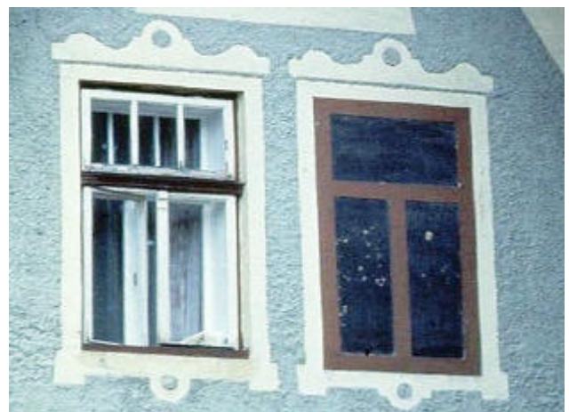
Altfenster brauchen Wartung und Sanierung.
